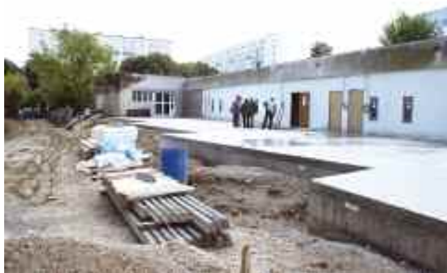
Les anciennes carrières ont été consolidées sous l'ensemble du bâtiment avant la construction de l'extension.
